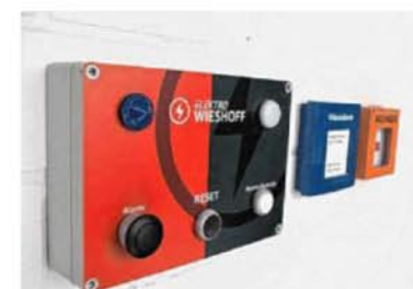
Wichtiger Knopf gleich hinter dem Eingang: Ist er gedrückt, werden alle Systeme hochgefahren, damit für den Einsatz und auch danach die Wache komplett vorbereitet ist.
