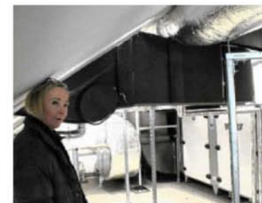
Unter dem Dach sind Klima- und Heizungstechnik untergebracht: Heike Voß von der städtischen Bauverwaltung in der neuen Feuerwache in Wengern.
